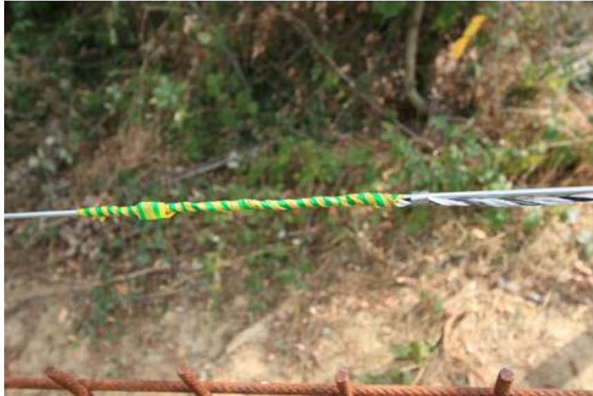
Corretta giunzione tra cavi (Az. Agricola i Pianacci, Scarperia)
